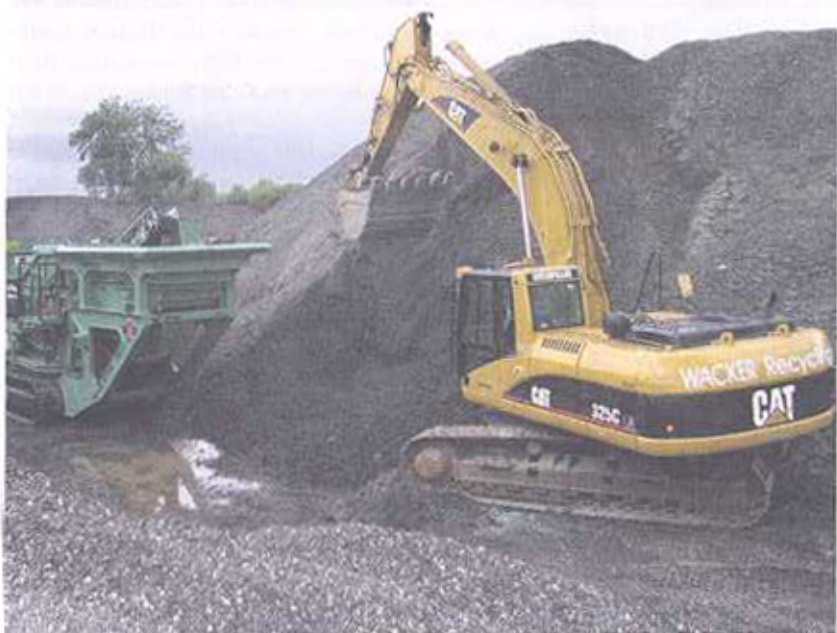
Stehen einander zur Seite beim Aufbereiten von Baustoffen: der Cat-Kettenbagger 325 C sowie die Prallbrecheranlage Giporec R131 FDR GIGA. Foto: Wacker
